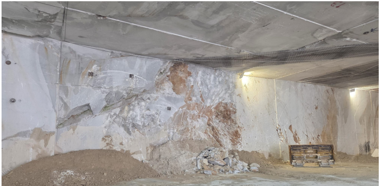
Particolare del fondo del ramo realizzato con visibili gli interventi descritti.
