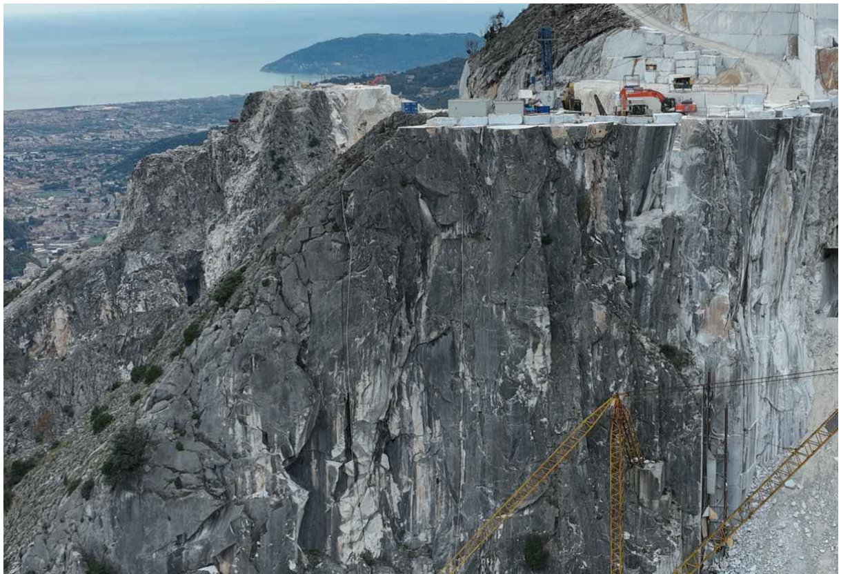
Panoramica della porzione superiore del fronte principale da asportare per garantire sicurezza delle aree sottostanti
