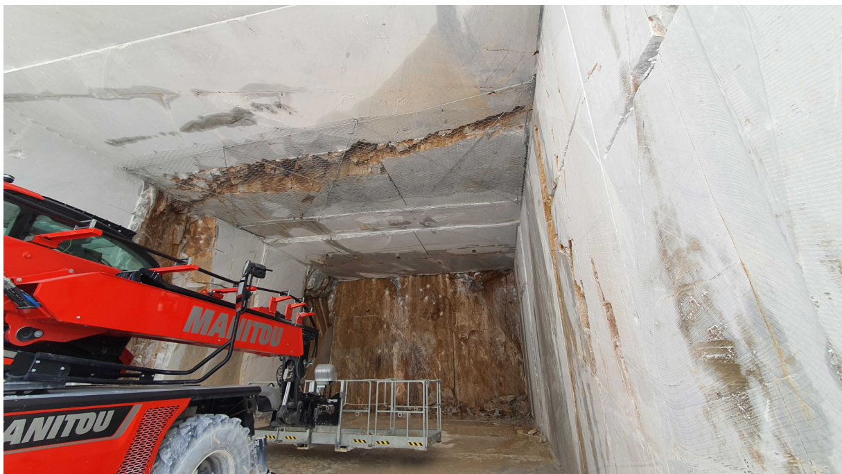
Particolare del tetto e degli interventi eseguiti (rete di protezione e tiranti).
