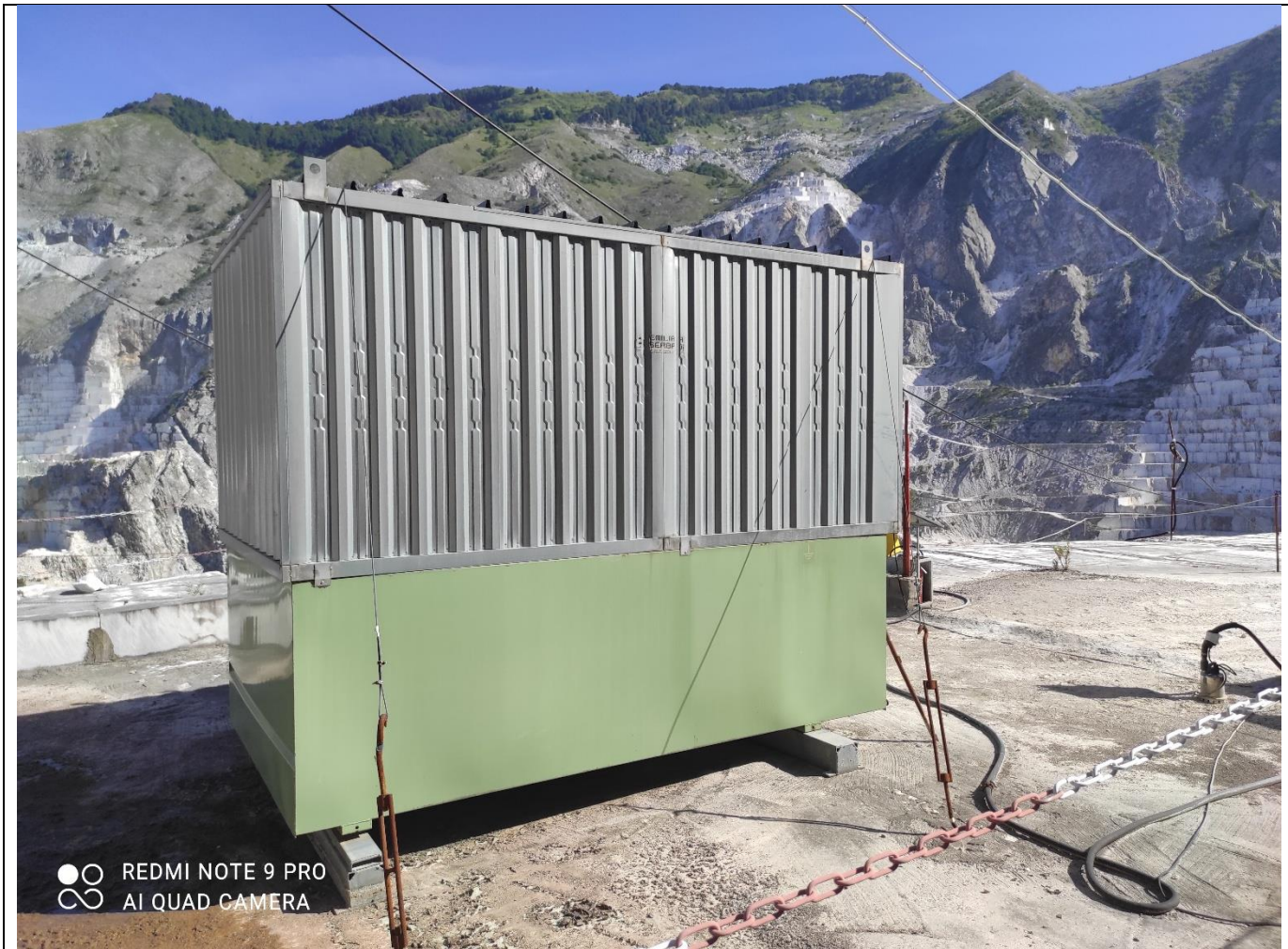
Foto 2: Panoramica dell'area impianti con osservabili: il cordolo marmoreo perimetrale, il punto di captazione acque e/o sversì accidentali e il cordolo in cemento che delimita l'ingresso della pala meccanica per il rifornimento
