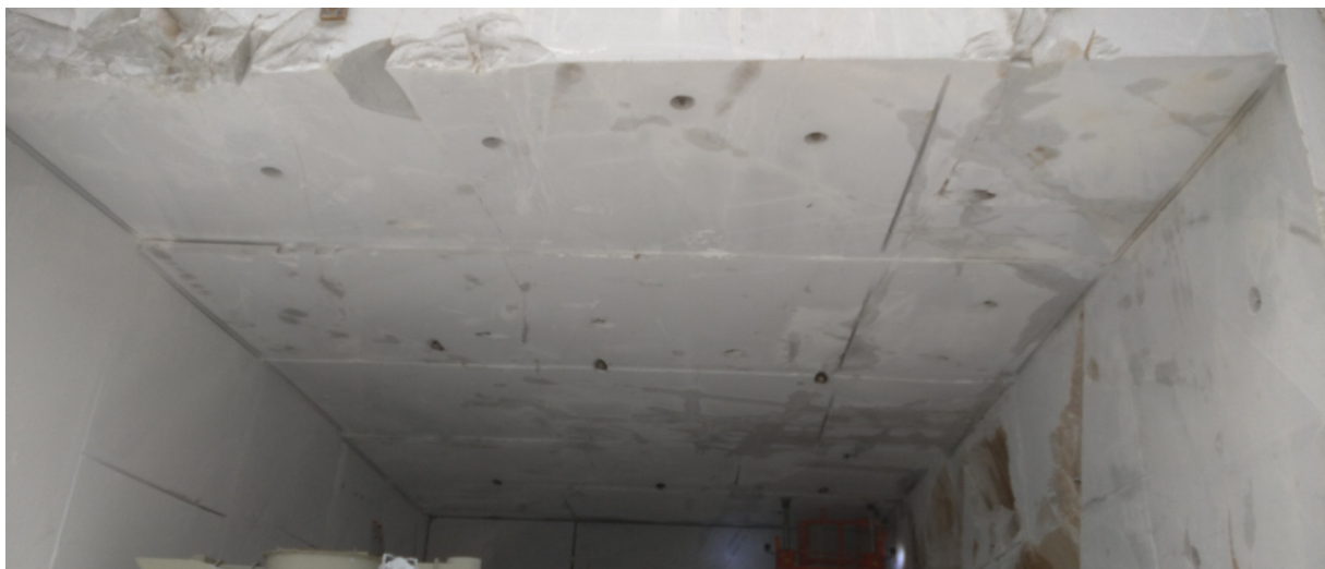
Foto 3 – Panoramica del tetto della galleria ad oggi realizzato con evidenziati in rosso i bulloni a 45^\circ .
