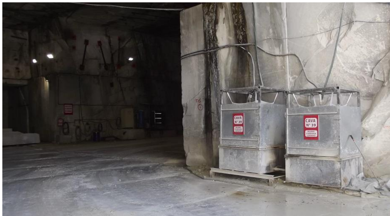
Figura 1: Ripresa dell'impianto di trattamento delle acque di lavorazione a sacchi filtranti in serie
