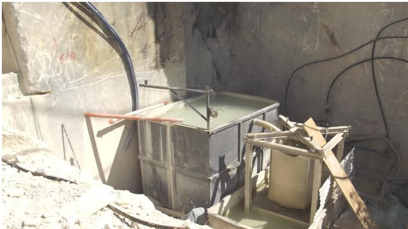
Figura 2: Ripresa dell'impianto di trattamento delle acque di lavorazione vasche di decantazione e sacchi filtranti
