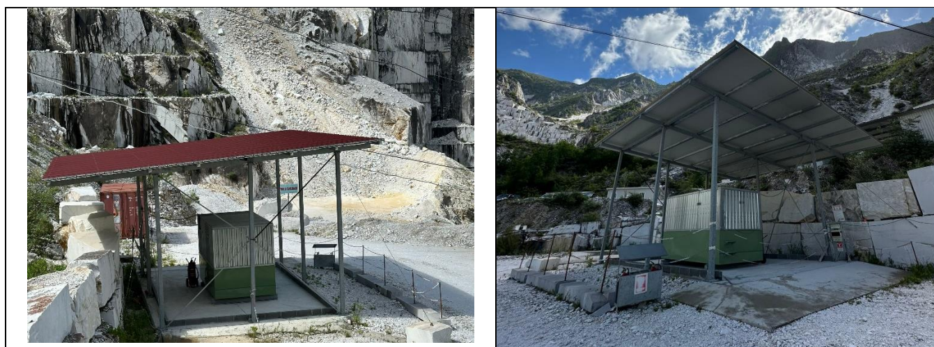
Foto 4 e 5: L'area impianti costituita dal serbatoio del gasolio vista dall'alto e di fianco, con entrata cementata per i mezzi
