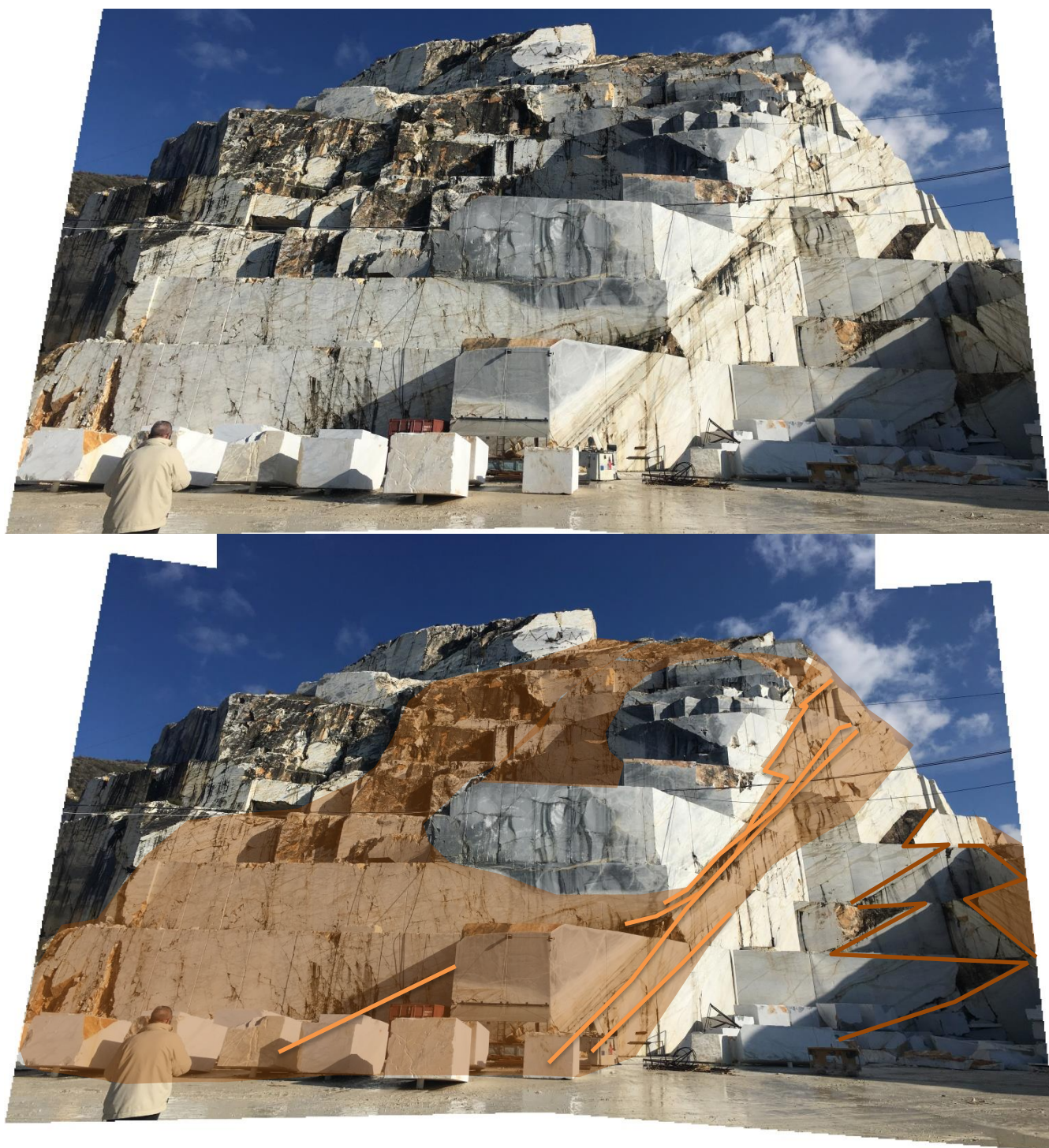
Figura 27: Ripresa della parte meridionale del settore centrale della tecchia con indicate le principali fratture e fasce cataclastiche.
